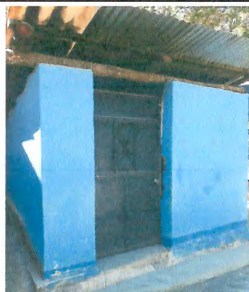
Foto 4: La Comunidad educativa prioriza necesidad de mejorar o sustitución del area de cocina (Techo, polleton y paredes)
